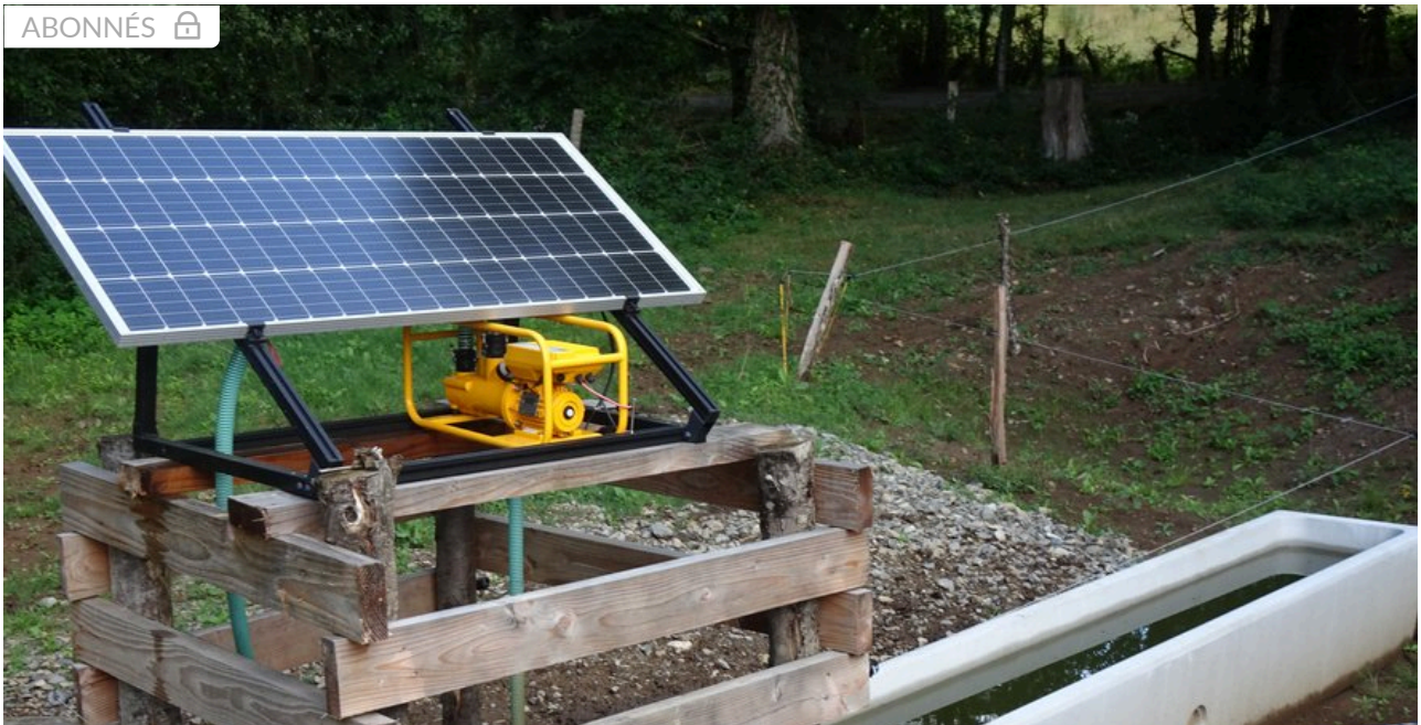
Un système de pompage solaire. DDM
